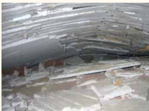
Etat de la voûte d'origine pesant sur la voûte en plâtre
