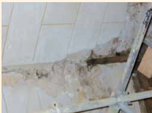
Dégâts sur l'ancienne voûte en plâtre qui s'effondrait
